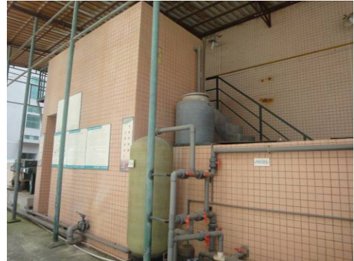
项目废水处理装置
