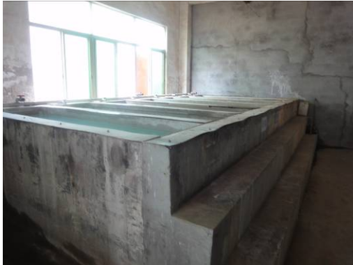
项目原有表面处理池
