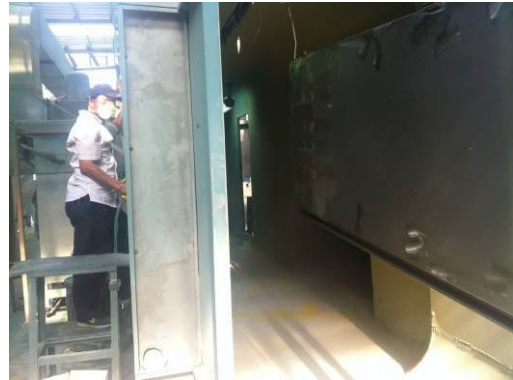
项目扩建增加喷粉柜 2
