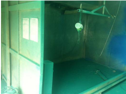
项目扩建增加喷粉柜 1
